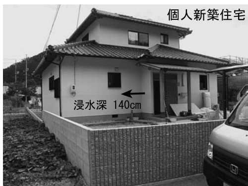
写真6 個人の新築家屋における浸水痕跡（山口県岩国市藤河，2005年9月25日撮影）
