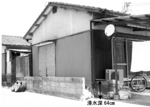
写真1 家屋における浸水痕跡（山口県柳井市南町3丁目，2005年8月5日撮影）
