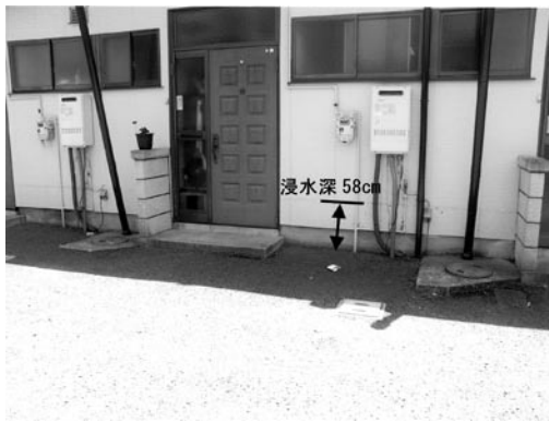
写真2 家屋における浸水痕跡（山口県柳井市大字柳井，2005年8月5日撮影）
