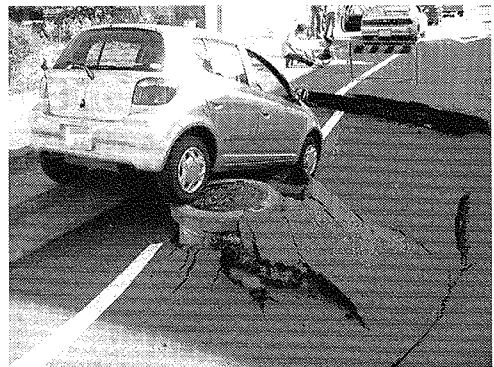
写真 12 マンホール周辺地盤の沈下と車 13)
