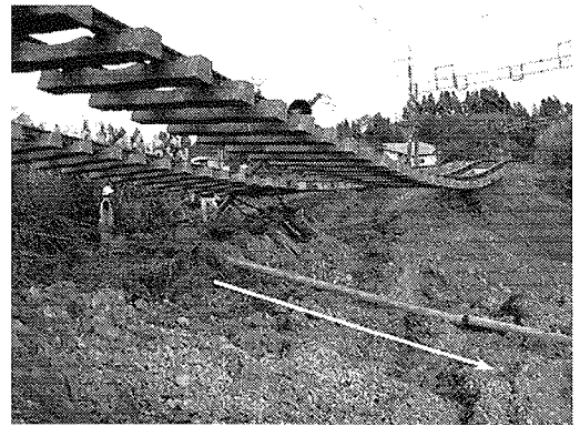
写真4 JR上越線小千谷駅ー越後川口駅間路盤の盛土流出
