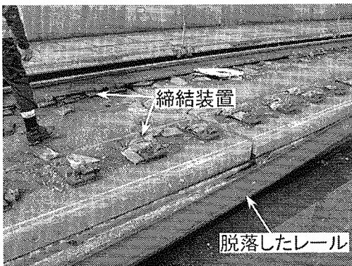
写真14 破損した締結装置
