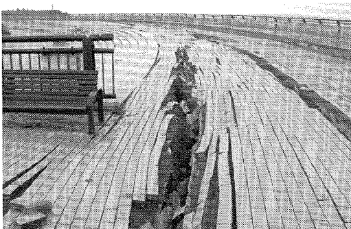
写真 5-6 千代の浦漁港の崩壊 (2003 年十勝沖地震 : 釧路市)
